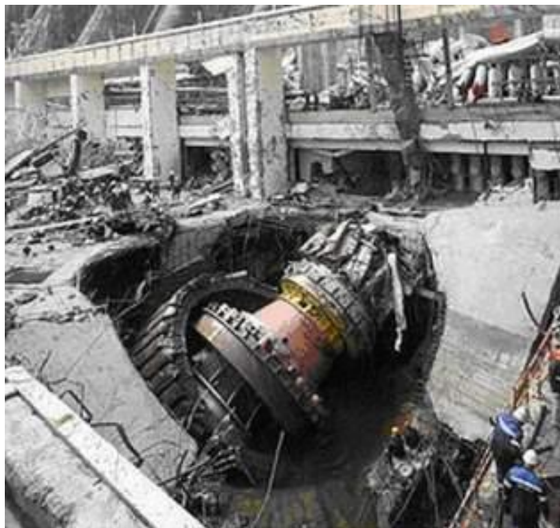
Рис. 117. Фото энергоблока и стёсанной им колонны.
